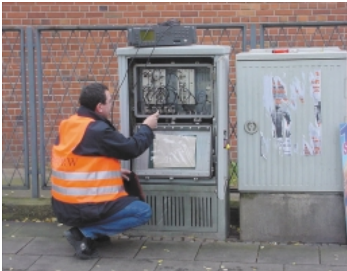
Um die teils maroden Kabelnetze rückkanalfähig aufzurüsten, ist es notwendig, die angeschlossenen Kabelverstärker auszutauschen, um so das Netz auf 862 MHz frequenztauglich zu gestalten
