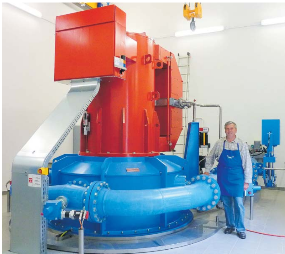
Initiator Alois Mair an der Pelton-Turbine, darüber rot der Generator
